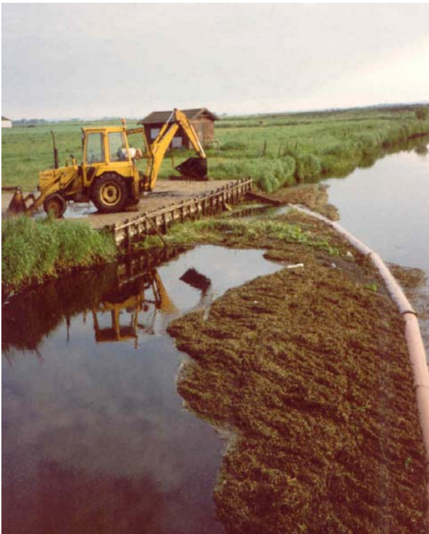
Grødeopsamling med flydespærring i større vandløb
